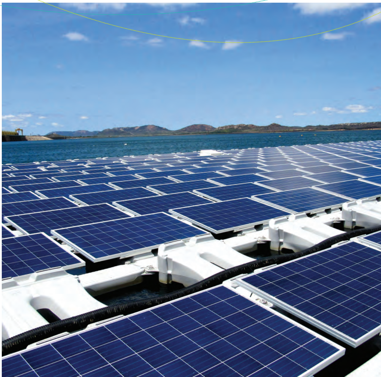
Placas solares flutuantes em Sobradinho. Eletrobras Chesf
